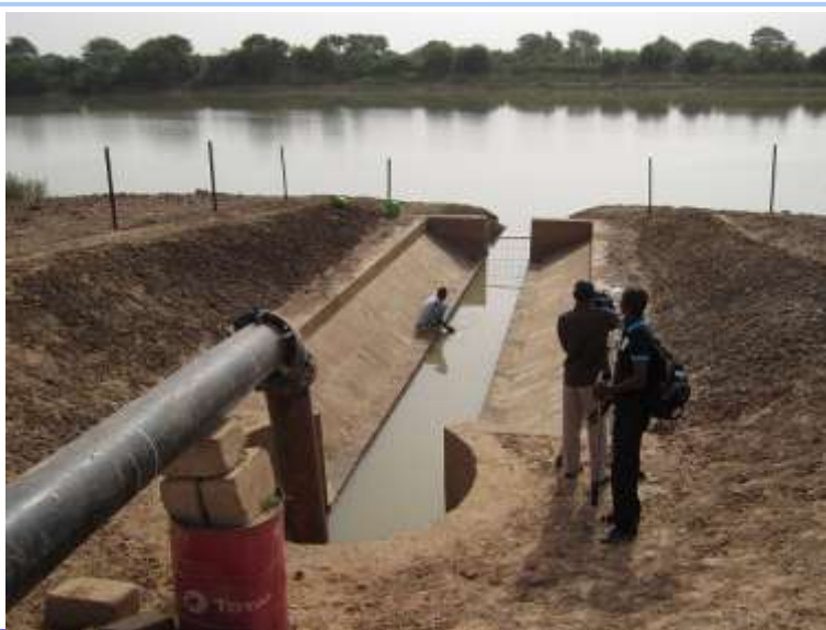
Canal d'amenée de la pompe et bassin d'aspiration
