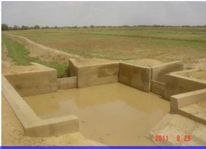
Réparation de répartiteur
