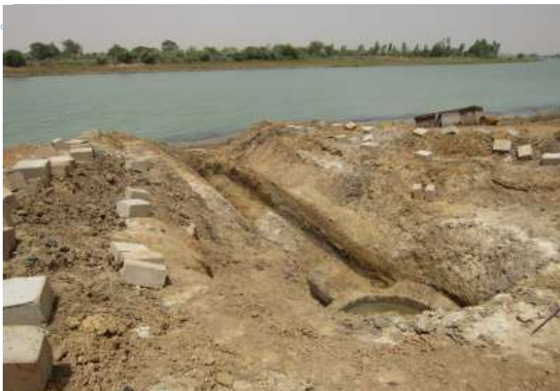
Canal d'amenée de la pompe et bassin d'aspiration
