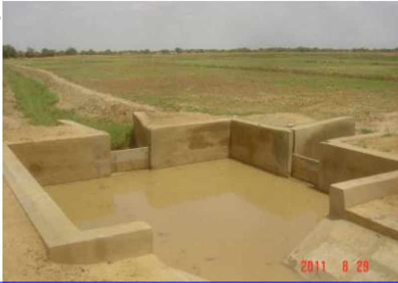
Réparation de répartiteur
