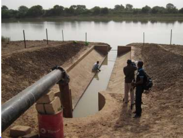
Canal d'amenée de la pompe et bassin d'aspiration
